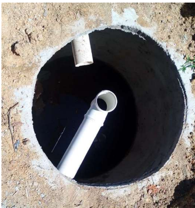
Foto 31 – Tubulações internas e brita dentro da fossa.
