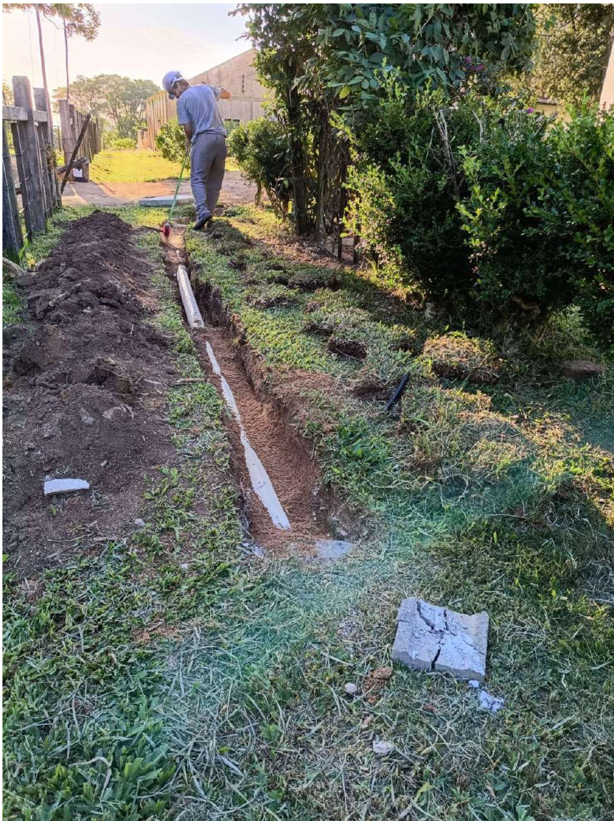
Foto 34 – Rede PVC 00 mm do filtro dos sanitários externos novos até a caixa de inspeção que liga a rede nova de tubos de concreto de 50 cm.
