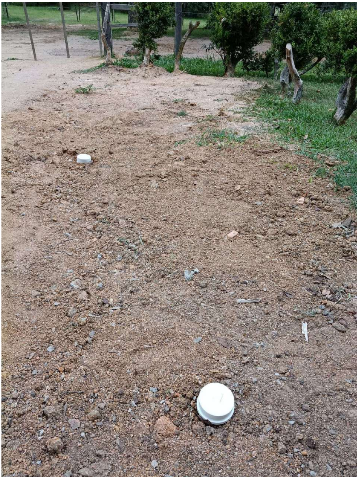
Foto 35 – Fossa e filtro tapados, com os tubos de limpeza na superfície.
