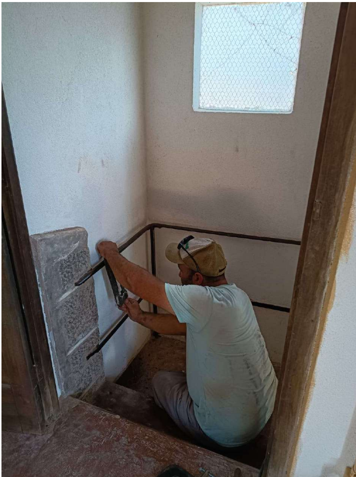
Foto 69 – Correção corrimão circulação acesso C47 3. Nível.
